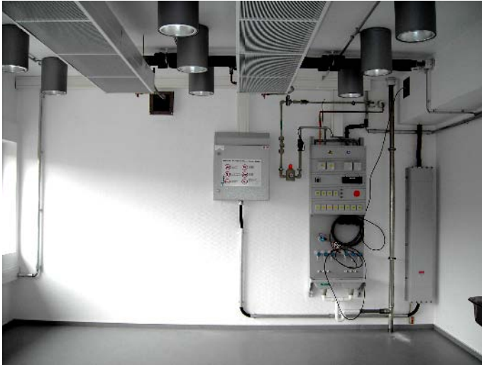
Bild 4.56 Geschirmter Laborraum, Foto: emscreen GmbH.
